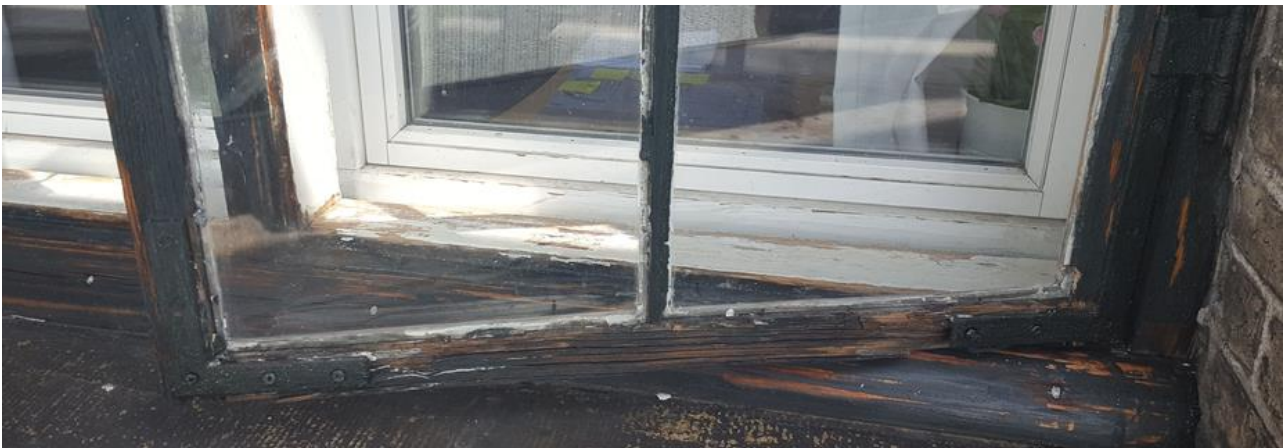
Eksempel vinduesramme hvor bundstykket skal skiftes.
